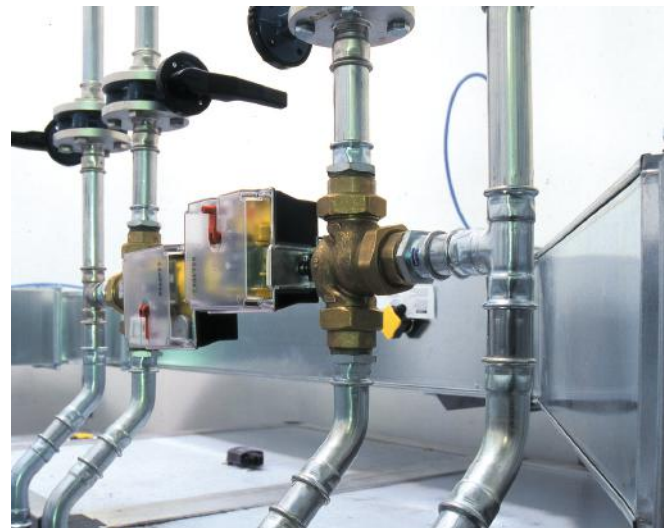
Figura 22 - steelPRES - Acqua di raffreddamento (circuitto chiuso)
